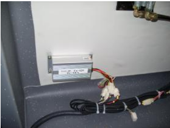
Расположение трансформатора напряжения 24-12 внутри дополнительной приборной панели.
